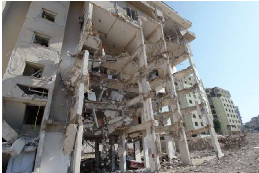
(PH①) 約3100棟が崩壊し、2万人以上の死者を出したアンタッキヤのマンション
